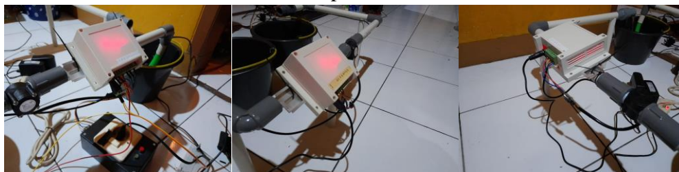
Gambar-11 Realisasi RTU1,RTU2 dan RTU3
